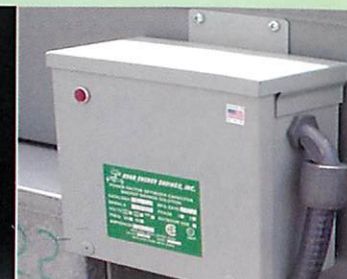
Installed KVAR PU-1200
